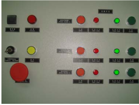
Fig. 16 光学棚屋外面的控制面板
