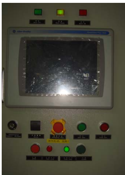
Fig. 3 实验棚屋外面的控制面板
