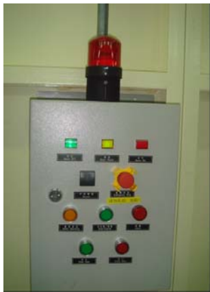
Fig. 15 棚屋内的控制面板
